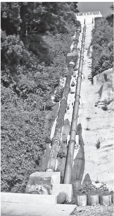
新旧の送水管(面白峡発電所、大多喜町)
